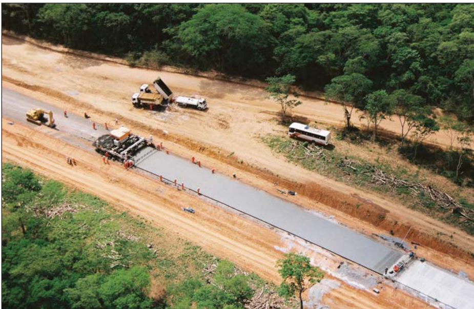
Colocado del pavimento rígido en el tramo San José - Taperas - Roboré (137,80 Km)
