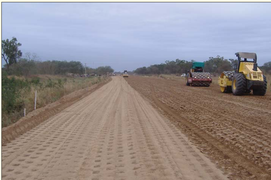
Conformación de terraplen en el tramo Paraiso - El Tinto (124,80 km), con un avance de obra del 35 %.
