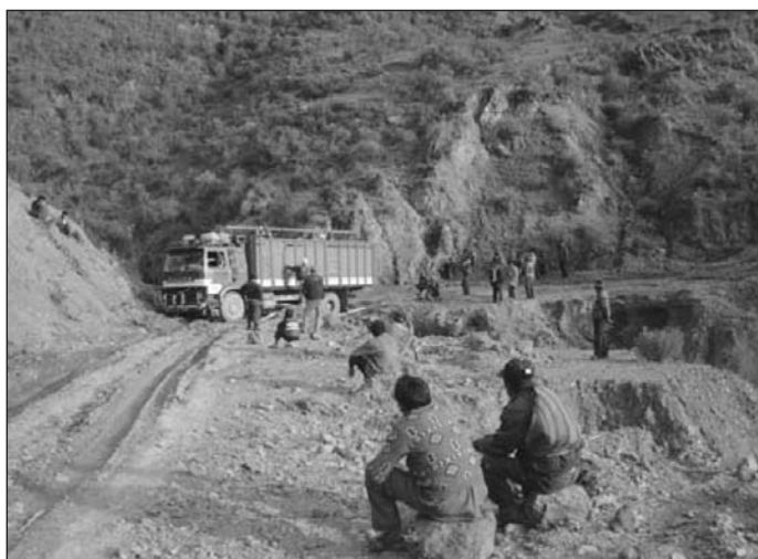
Camino vecinal en muy mal estado, perjudicando el tránsito normal de camiones, consecuencia del desmoronamiento de taludes y la falta del mantenimiento en las alcantarillas
