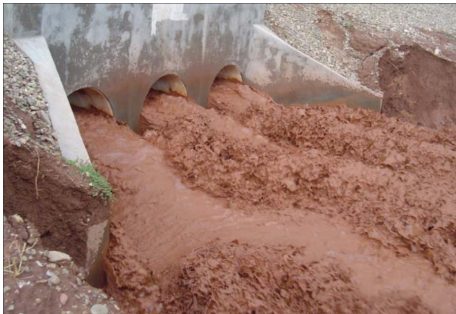
Alcantarilla de tres tubos, TUBOFLEX, en pleno funcionamiento (Carretera Paraguay - Bolivia)
